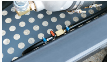
Grifo de vaciado de agua del tanque de combustible
